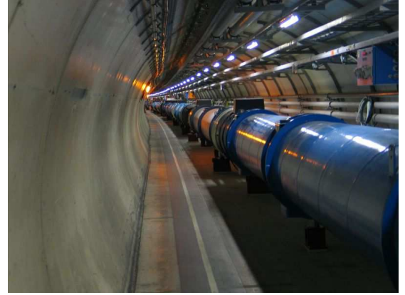
FIG. 2.3 – Dipôles installés dans le tunnel du LHC [30]
