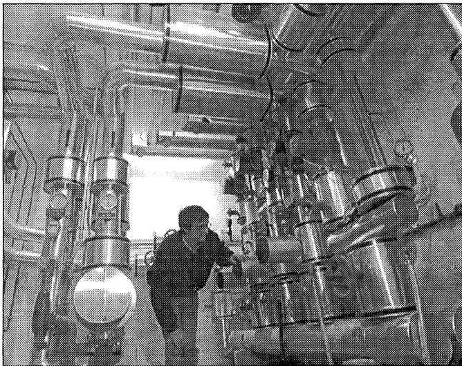
Sous-station du système de chauffage qui distribue l'eau chaude dans le bâtiment, à une température optimale dépendant des instructions du contrôleur programmable.
