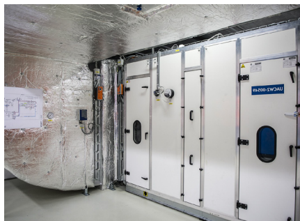
Cette photo montre une des nouvelles unités de ventilation ainsi qu'une des conduites d'air installées à l'occasion du projet de consolidation du Centre de calcul.
